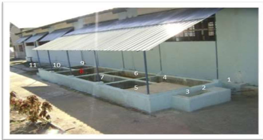
Figura 21. Planta de tratamiento de la fábrica de pintura ubicada en Boniato
