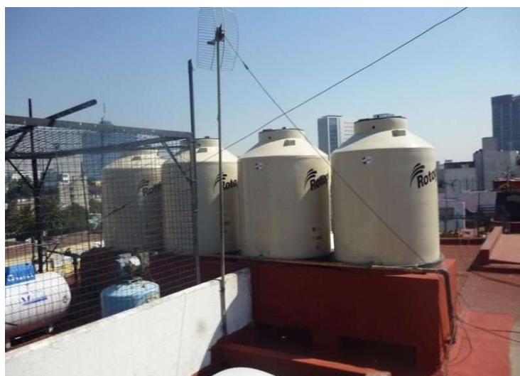
Figura 2.13. Tanques elevados sobre la cubierta de una edificación
