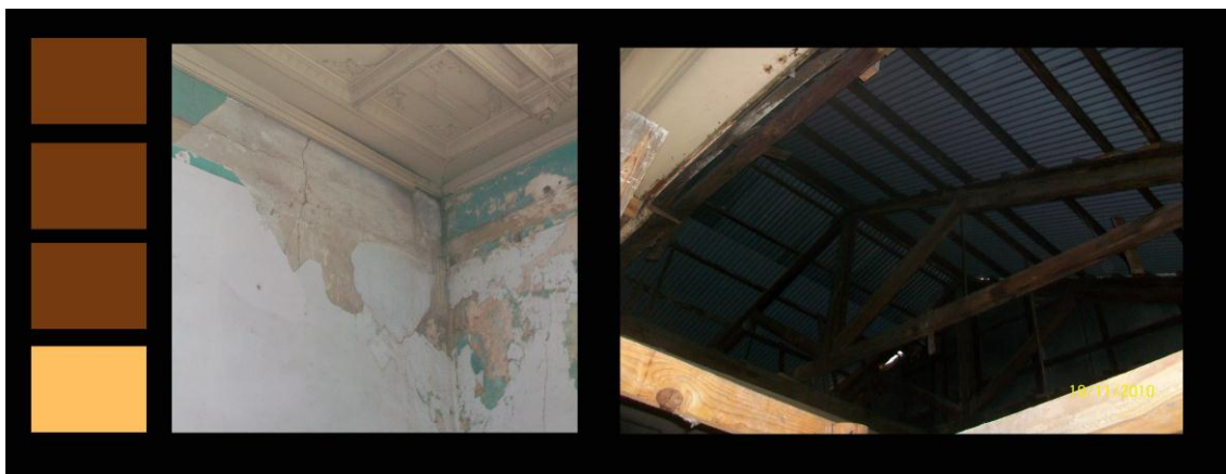
Fig.12 Se observa una grieta en la intersección de los muros, también fisura muro izquierdo. En la Fig. Derecha se aprecia la situación de la estructura de la cubierta.
