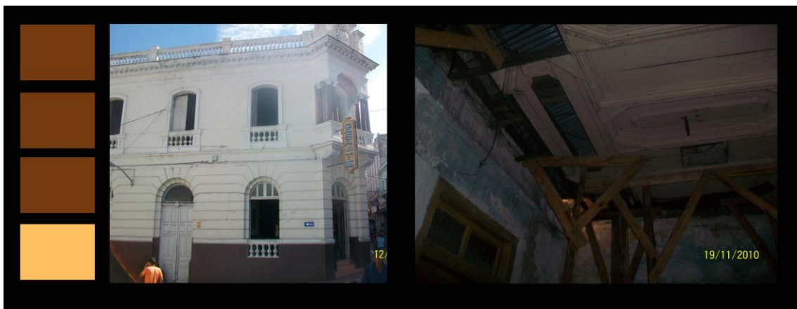
Fig.15 Fachada San pedro, Ausencia o mutilación de la carpintería de los vanos.
