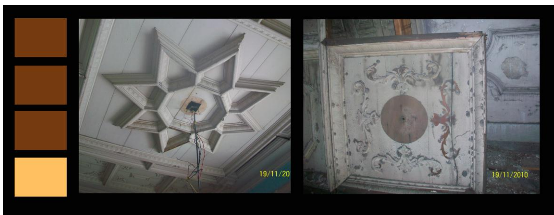
Fig.18 Falso Techo falta de elementos componentes decorativos de madera
