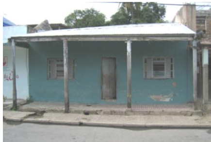
Foto 44. Vivienda N° 105 en la actualidad, nótese las transformaciones efectuadas en la fachada y la pésima ejecución en la sustitución de la cubierta.
