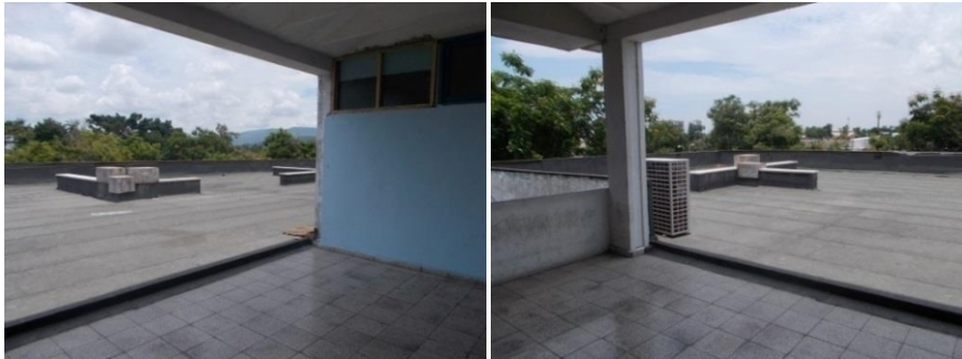
Facultad de construcciones. Sede Julio A. Mella. Universidad de Oriente. Se señalan, la terraza y la unidad de acondicionamiento expuestas bajo la incidencia solar. Orientación sureste.
