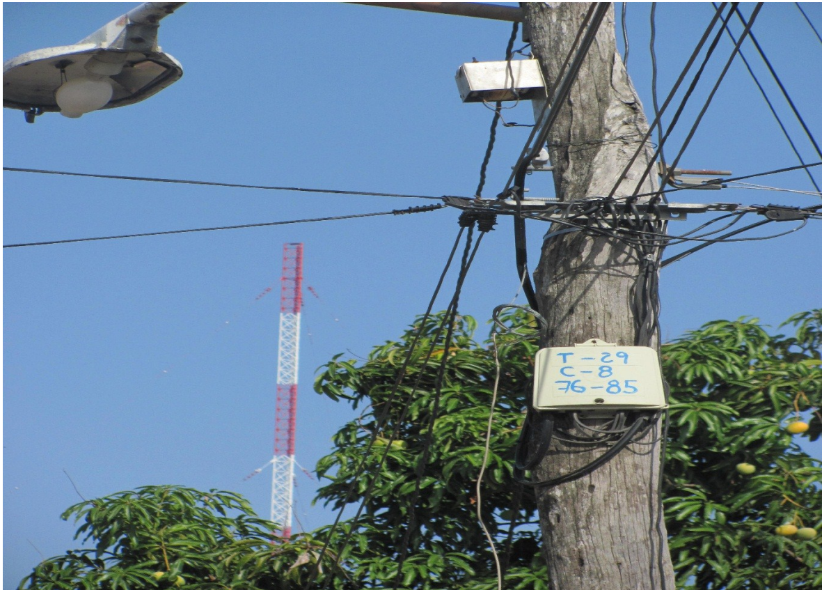
Figura 3.3. Caja terminal más cercana al transmisor de Santa María. (Imagen del autor)
