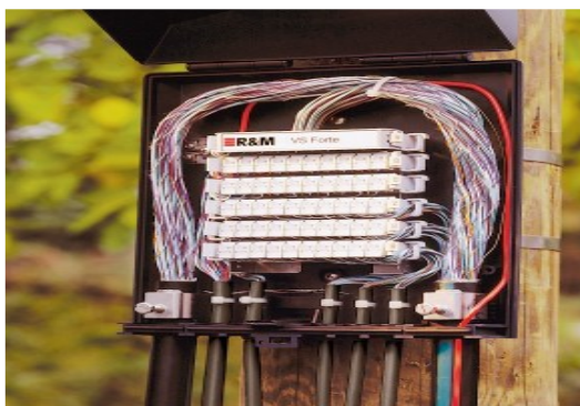
Figura 1.12. Terminal de 60 pares.
