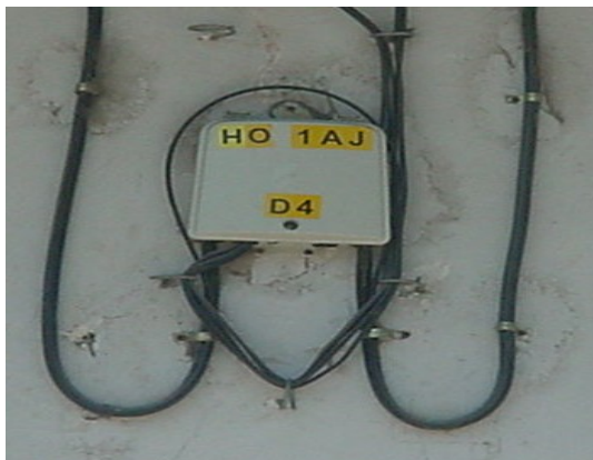
Figura 1.14. Caja Terminal de Multiservicio
