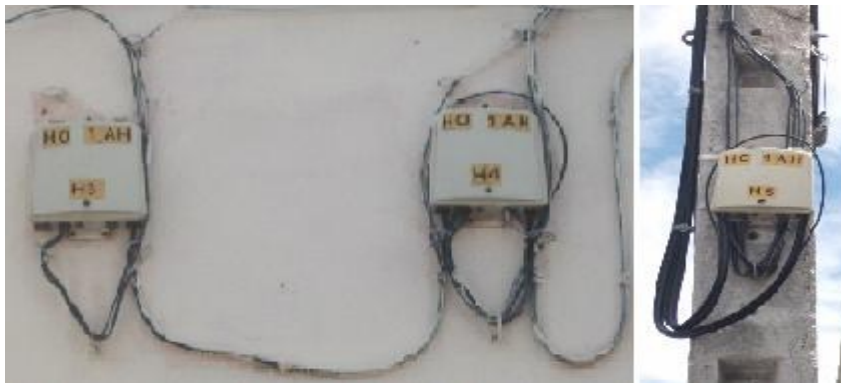
Figura 1.9. Caja terminal sobre fachada y poste.
