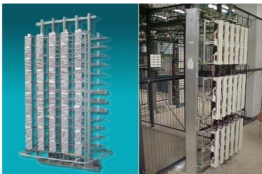
Figura 1.7. Repartidor principal o distribuidor general (MDF).
