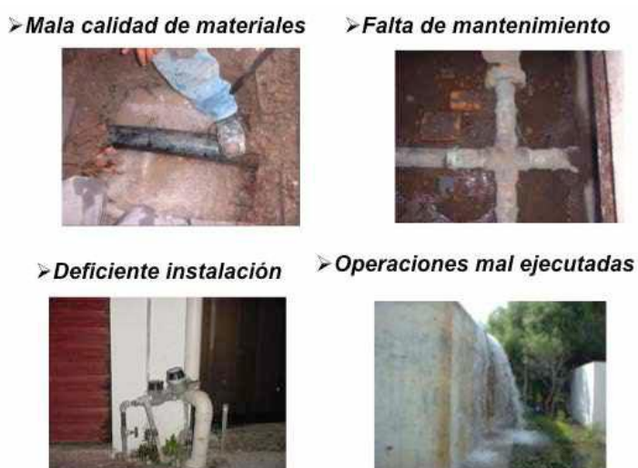
Figura 1.3. Otros tipos de fugas en sectores hidrométricos. Fuente: Ochoa, (2020).
