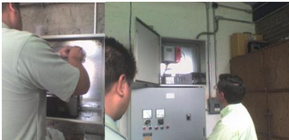
Figura 1.5 Medidor electromagnético en tanque bajo lado Norte y Sur, respectivamente. Fuente: Ochoa, (2020).
