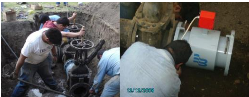
Figura 1.6. Instalación de Medidores Electromagnéticos. Fuente: Ochoa, (2020).
