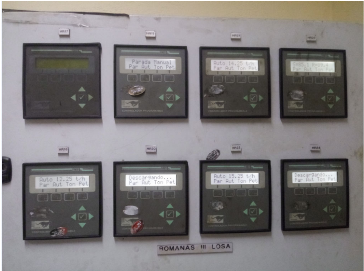
Montaje de las 8 CPU del EROSPLC-D en el panel central de la losa III.
