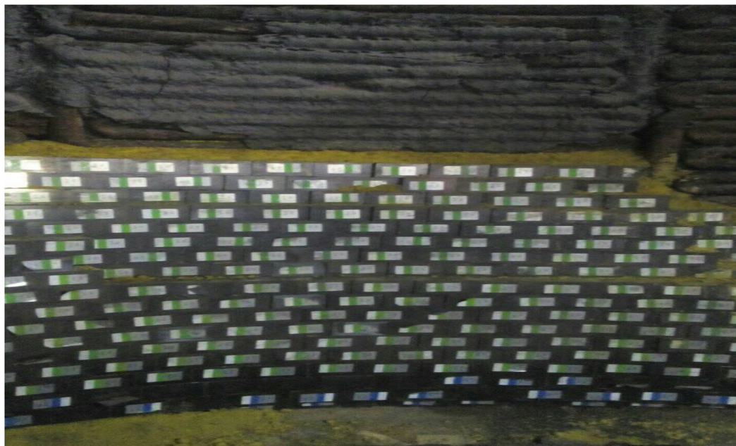
Figura 4: Fotos tomadas a las paredes de un nuevo HAE de ACINOX Las Tunas:
