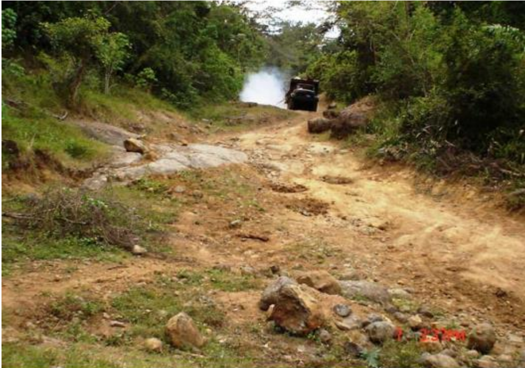
Foto 8. Vial deteriorado que comunica la comunidad Las Coloradas con Campo Rico (diciembre 2005).
