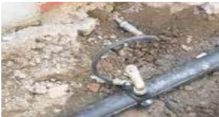
Foto 4: Acometida de Agua
