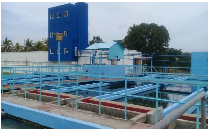
Foto 3: Planta Potabilizadora Guaso.
