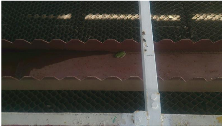
Figura 11. Canaletas con vertedores triangulares en los laterales.
