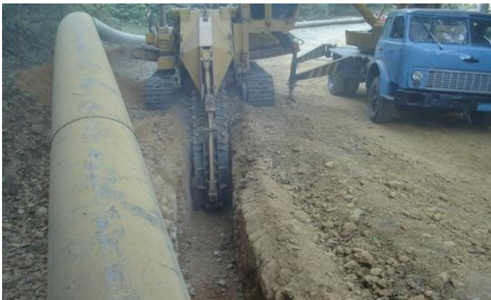
Figura 5. Conductora desde obra de toma hasta el tanque y planta potabilizadora.
