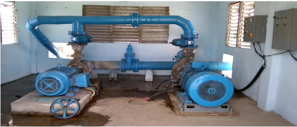
Fig. 1.2 a. Sistema de bombeo de impulsión de agua para acueducto.
