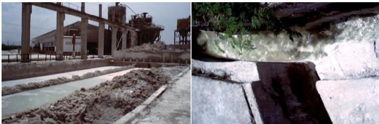
Figura 3.5. Decantador de la Fábrica de Asbesto Cemento y salida de evacuación de las aguas residuales de la Fábrica de Asbesto Cemento. Fuente: (Valdés et al. , agosto, 2014).
