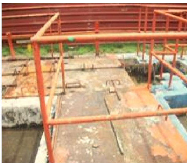
Figura 3.3. Decantador de ERASOL. Fuente: (Valdés et al. , 2014a).
