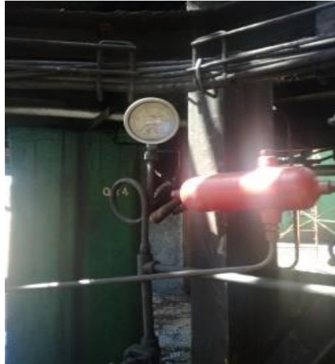
Figura 8. Manómetro empleado en la planta.
