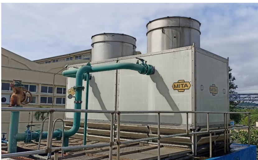
Figura 12. Torre de Enfriamiento. Fuente: Autor, 2023.
