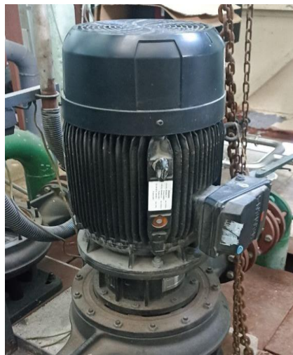
Figura 10. Bomba de agua enfriamiento. Fuente: Autor, 2023.
