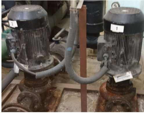
Figura 9. Bombas de agua refrigerada. Fuente: Autor, 2023.
