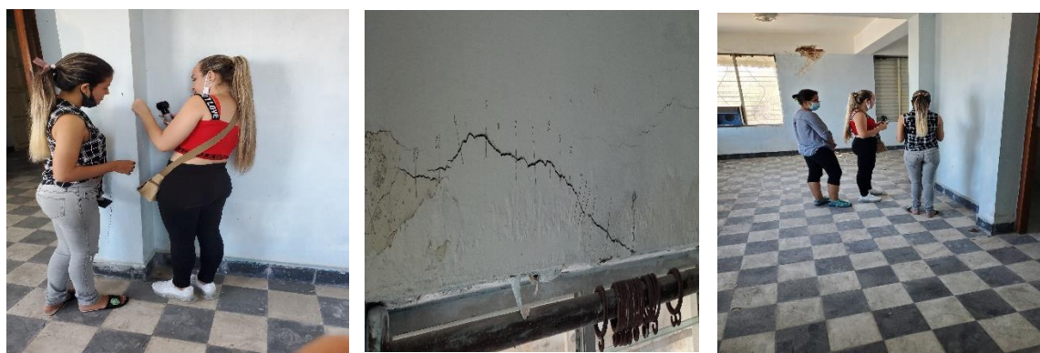
Figura 2.17. Levantamiento y medición de fisuras
