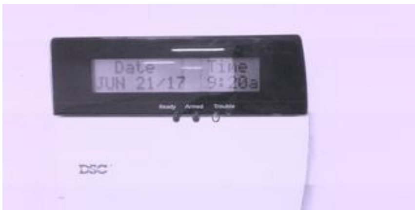
Figura 4 Interfaz de supervisión local ubicada en el Edificio Administrativo de la Universidad de Oriente en Santiago de Cuba
