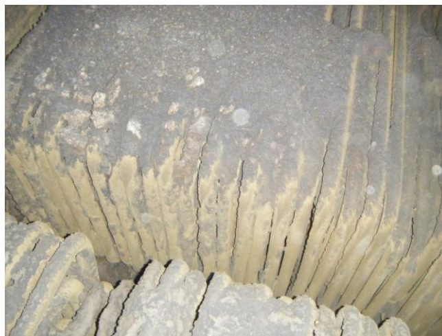
Figura 1. 6: Residuos de cenizas en tubos que conforman el Recalentador.
