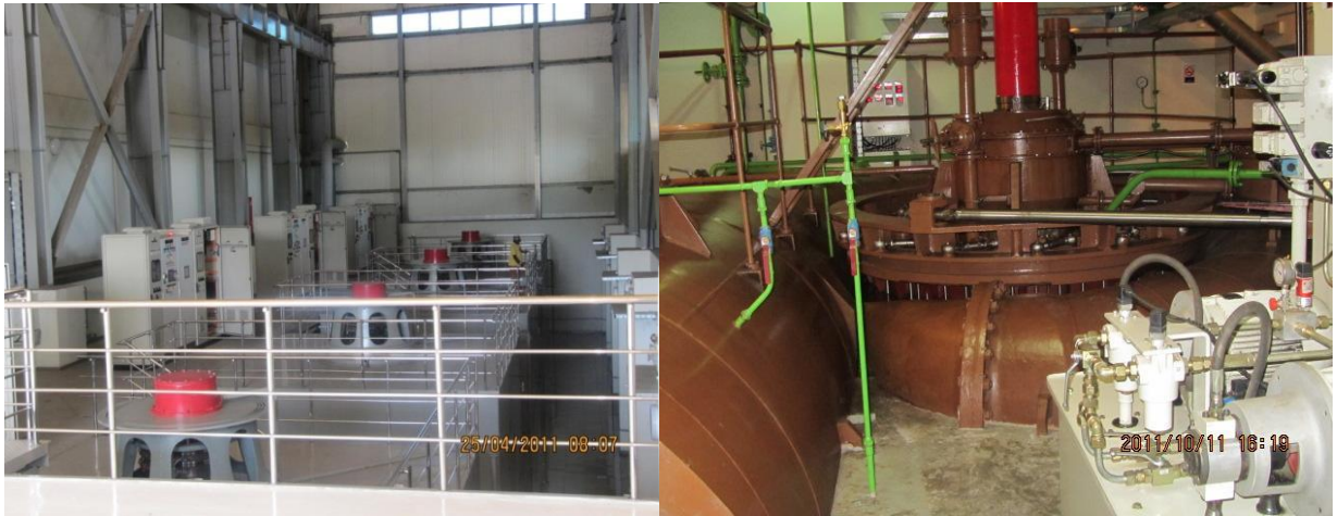
Figura 1.2.c. Sala de alternadores y turbina de la central hidroeléctrica Chicapa.
