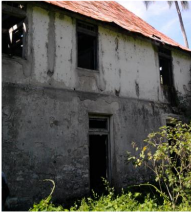
1. Daño: Ausencia de Carpintería.
