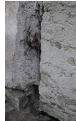
3. Daño: Deterioro en elementos estructurales.
