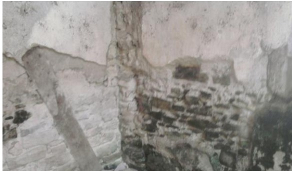
4. Daño: Desconchado en muro.
