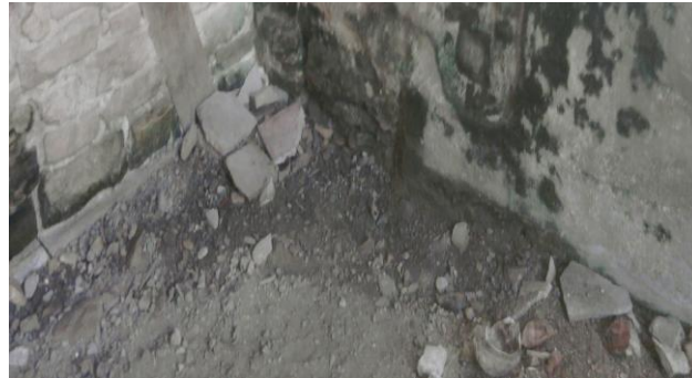
5. Daño: Ausencia de
